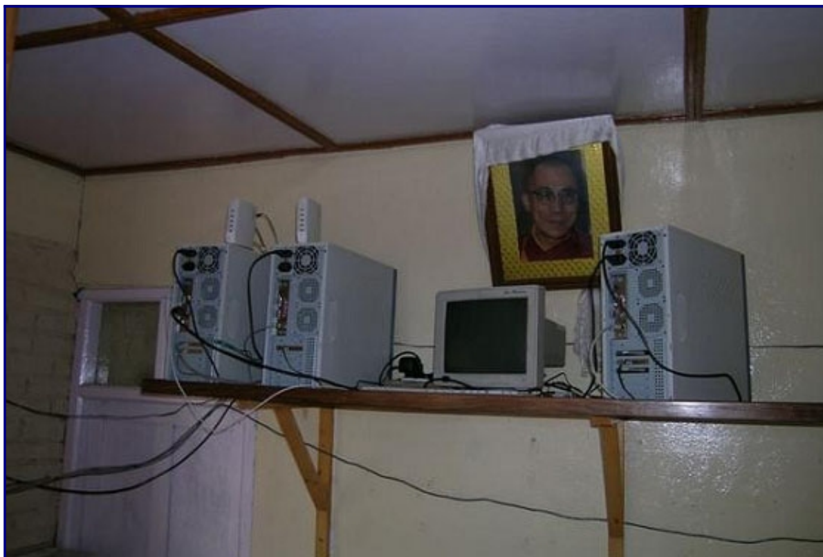
Figura 12: Equipos Mesh de Dharamsala
